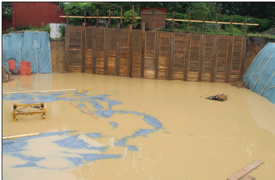
Abbildung: Gesamte Baugrube nach dem Starkregen vom 14.07.2021
