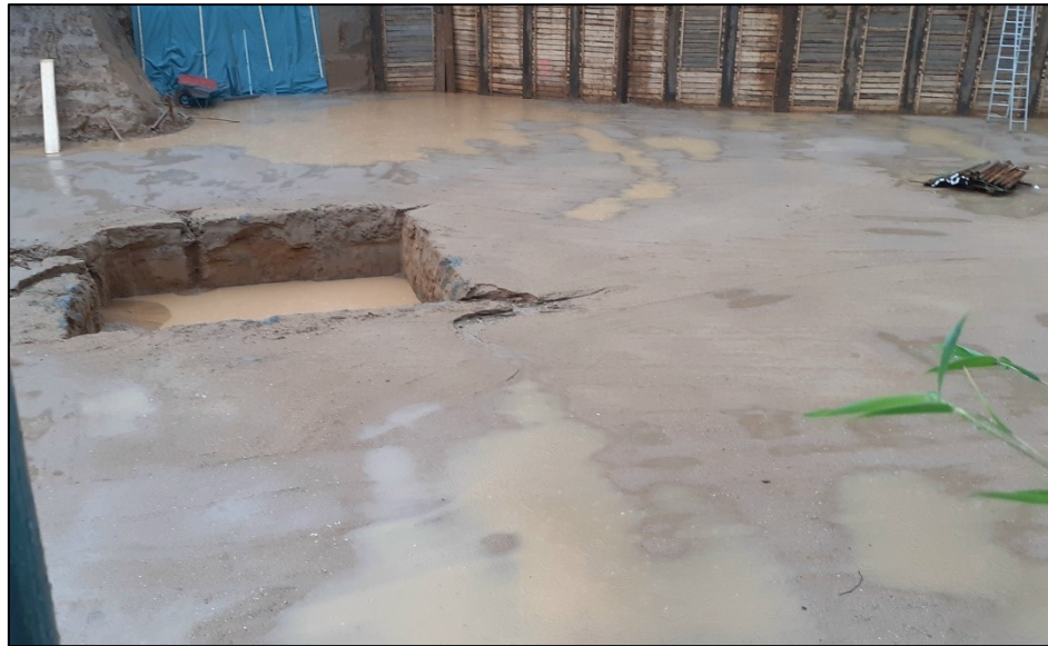
Abbildung: Zustand nach dem Starkregen am 15.07.2021
